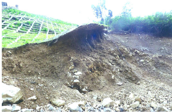
図 3.32 法枠工下部の地盤の抜け落ち状況 4)
