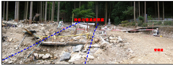
図 3.43 流路工閉塞状況 4) (撮影方向③)
