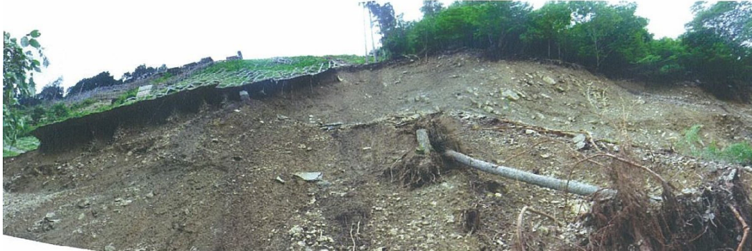
図 3.31 法枠工の被災状況 4)
