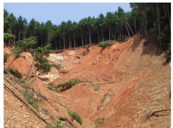
図 3.9 崩壊斜面の源頭部
