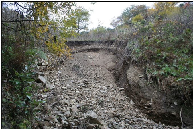
图 3.52 支流源頭部斜面崩壊状況（撮影方向⑫）
