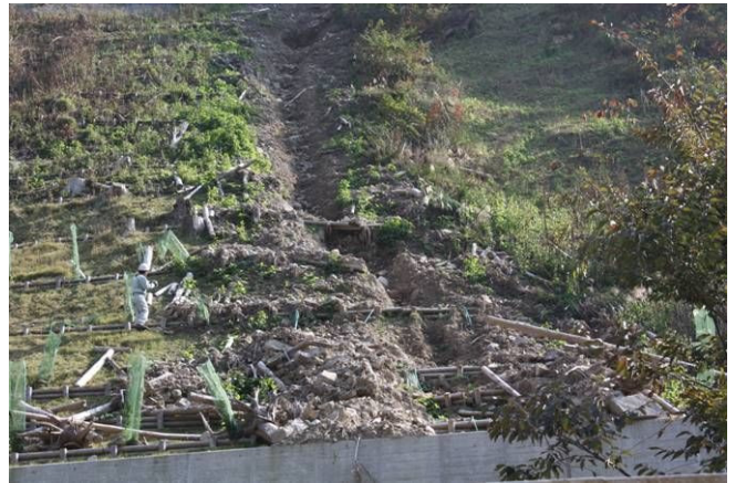
図 4.23 崩壊地下部の流出状況
