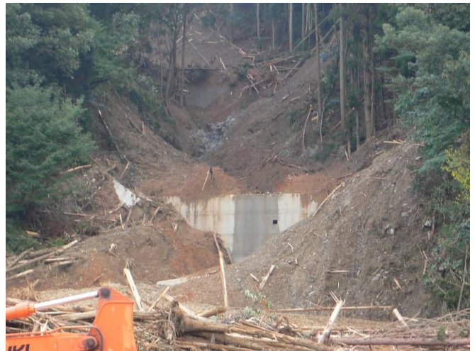
図 3.6 下から見た崩壊地の状況
