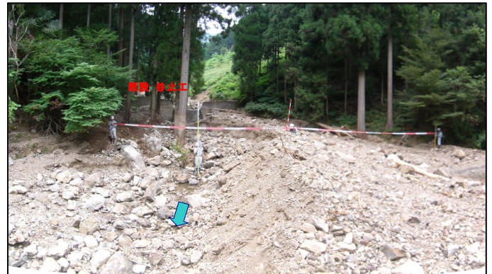
図 3.44 下流付近土砂堆積状況 (撮影方向④)
