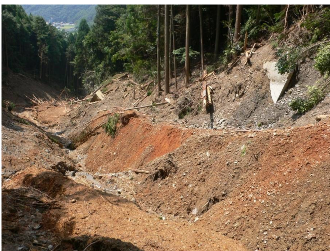
図 3.8 斜面上部より見た崩壊地
