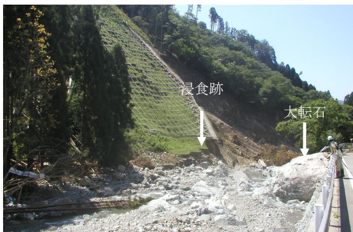
図 3.29 流水による浸食状況（上流側）
