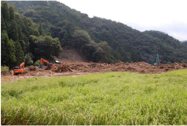
図 3.5 崩壊地の下部の状況
