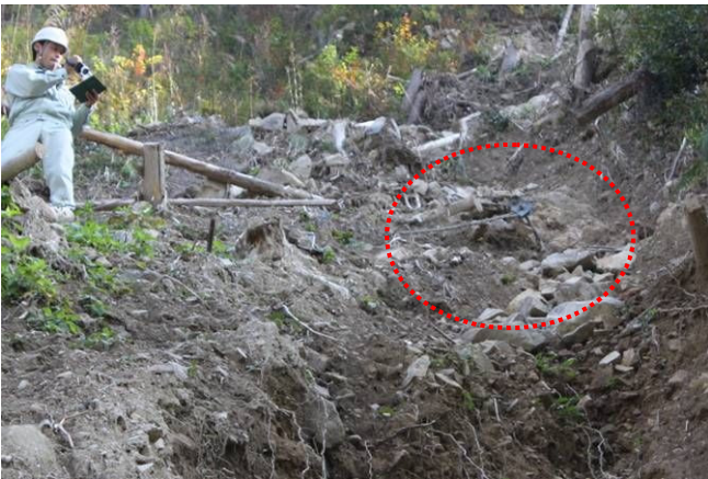
図 4.22 アンカー露出状況
