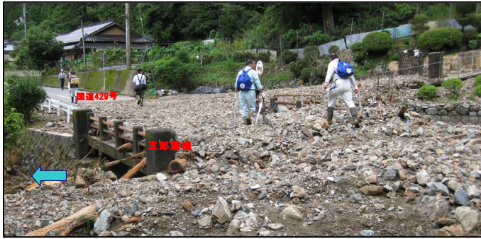
図 3.41 国道 429 号付近被災状況 4) (撮影方向①)
