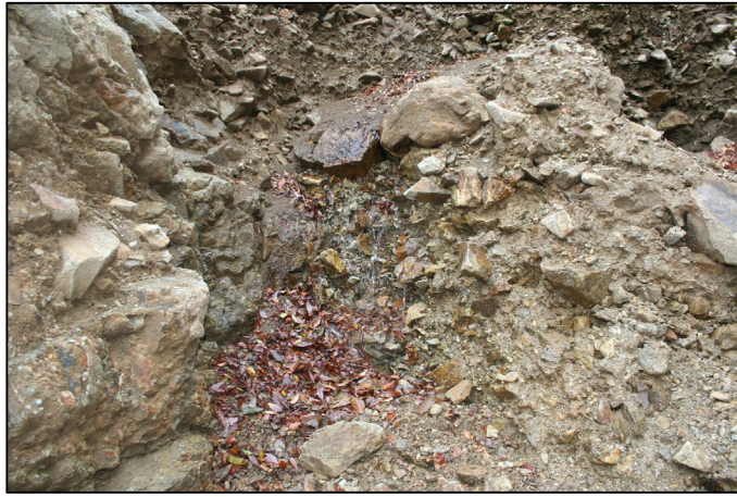
図 3.56 崩壊斜面中に見られる湧水状況
