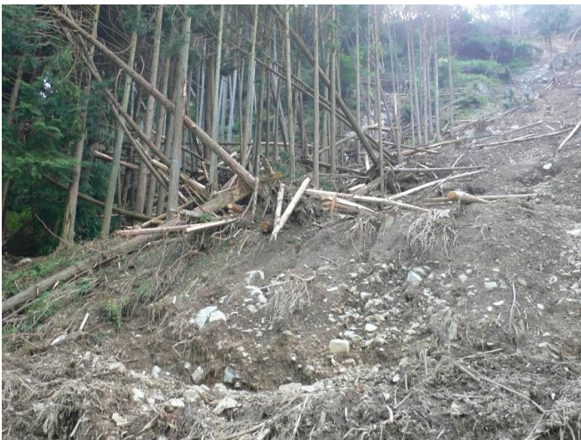
図 3.16 崩壊地の下部の状況
