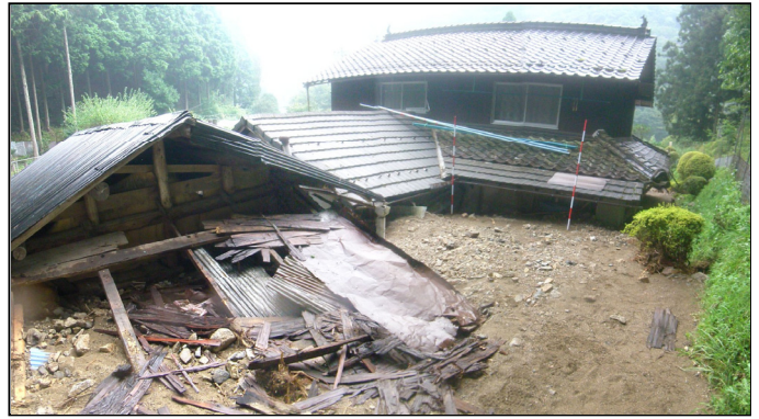
図 3.42 被災状況 4) (撮影方向②)
