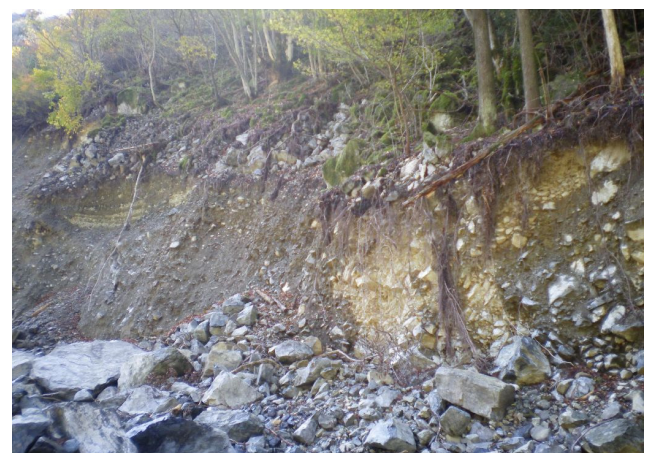
図 3.30 流水による浸食状況（下流側）
