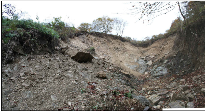
图 3.51 本流源頭部における斜面崩壊状況（撮影方向⑪）
